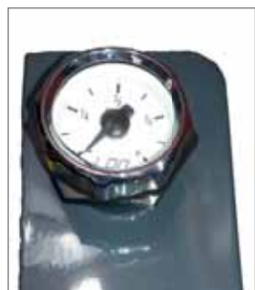
Contrôle du niveau d'eau
